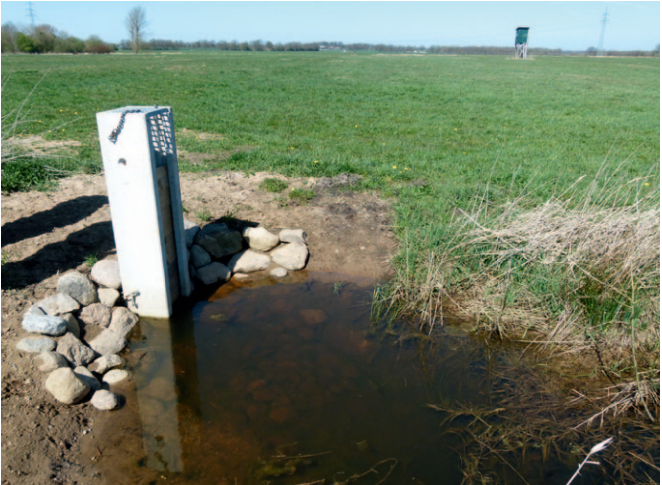
Abb. 2: Mönch mit herausnehmbaren Staubrettern am Hauptentwässerungsgraben am 21.04.2015 Foto: DVL SH
