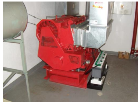
Abbildung 4 Die Netzersatzanlage (stationär) des Feuerwehrhauses in Korbach nach Quelle [4]
