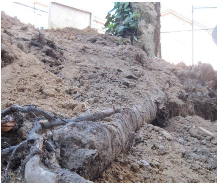
Offene, beschädigte Baumwurzel aufgrund unzureichender Baustelleneinrichtung und Baumschutzmaßnahmen sowie einer nicht ausreichend fachkundigen Bauleitung
