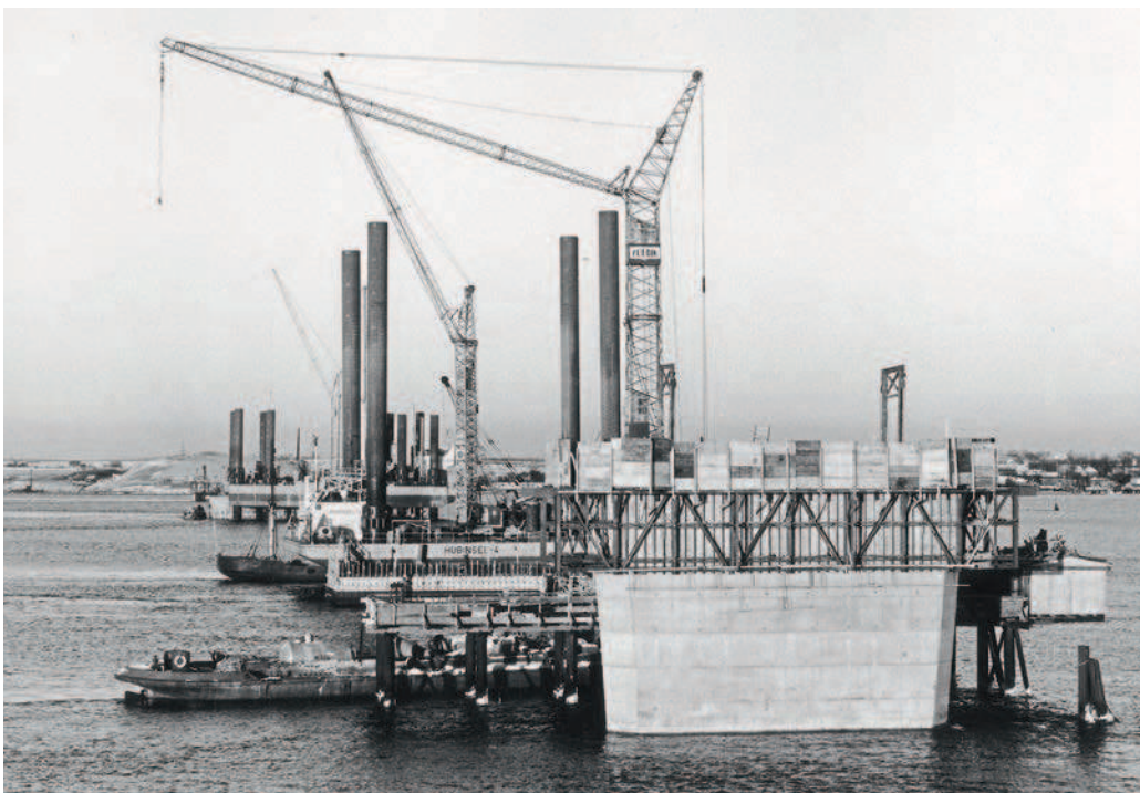
14 Blick über die in Bau befindlichen Pfeiler in unterschiedlichen Ausbaustufen, dazwischen die Hubinseln.
