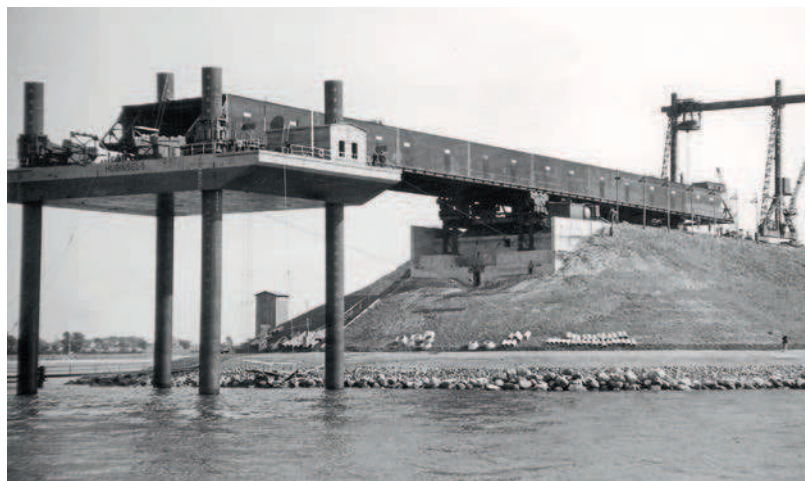
19 Einschiebevorgang für das erste Nebentragwerk auf die Hubinsel 5 zwischen der Festlandrampe und Pfeiler 1.
