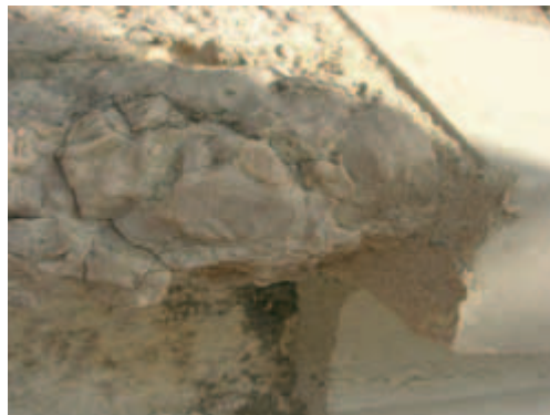
13 Nebeneinander von erhaltenem originale Gotlandstein und erneuertem Gesimssteil.
