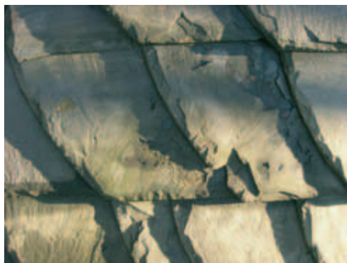
16 Schäden an der Schiefer-eindeckung.
