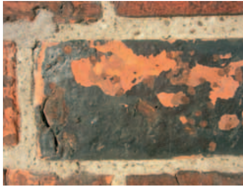
14 Detail eines stark gerissenen, aber weiterhin erhaltenen Mauerziegels.
