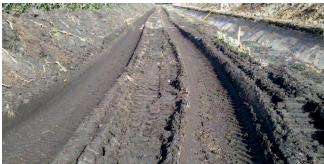
Abbildung 1: Tiefe Fahrspuren entlang eines Lei- tungsgrabens
