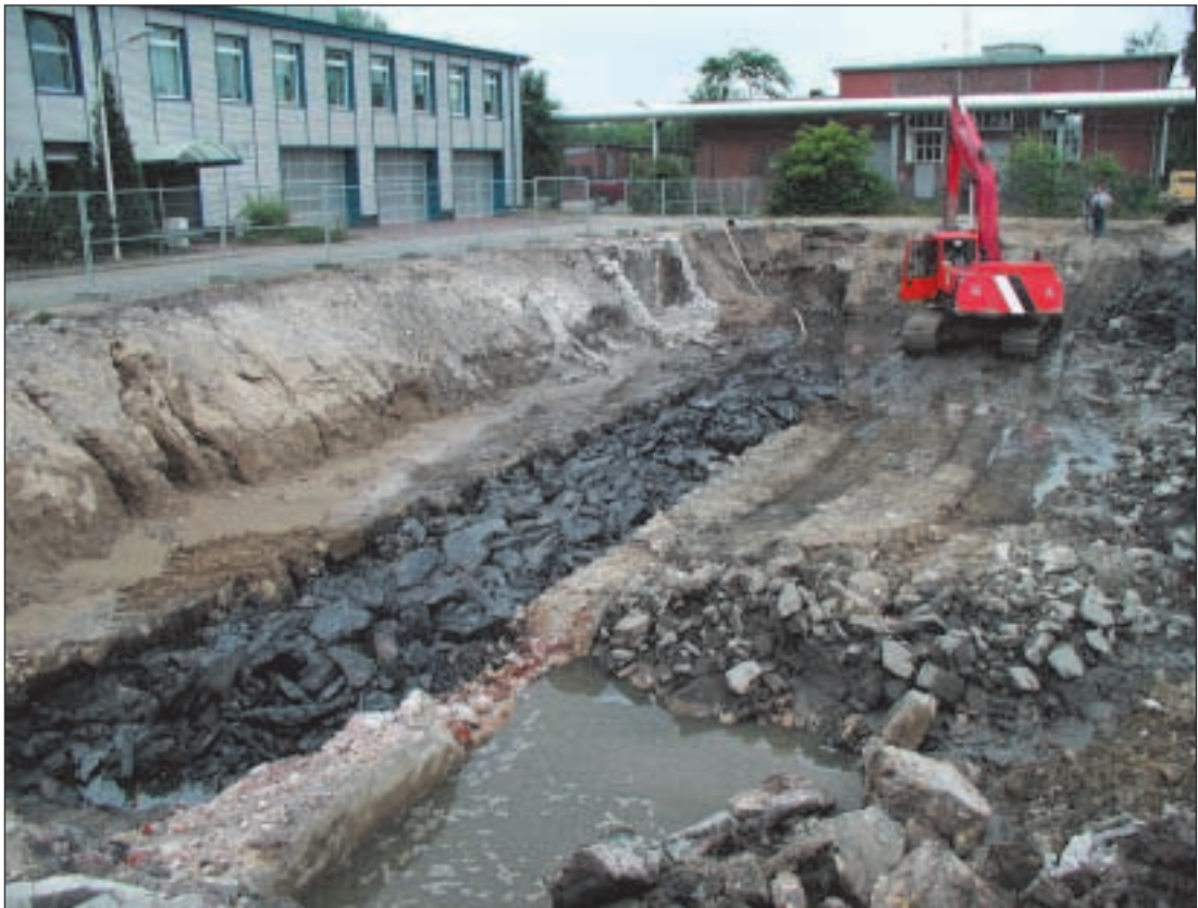
Abbildung 13: Stark kontaminierte Massen
